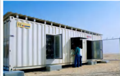
沙特电信项目 Telecom project in Saudi Arabia
