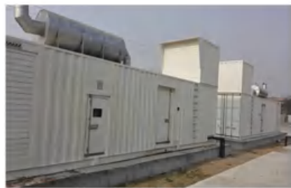
北京祥云睿为亦庄数据中心项目 Beijing xiangyun ruiwei yizhuang data center project
